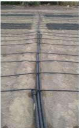
Instalasi Sistem Irigasi Tetes
